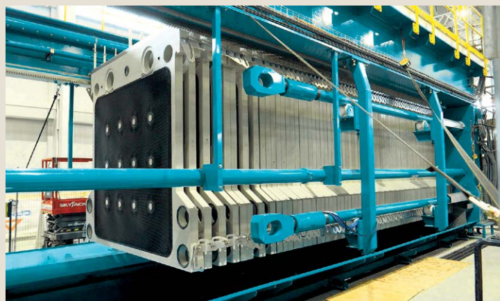
Les plaques de compression commencent à être installées dans les filtres-presses.
