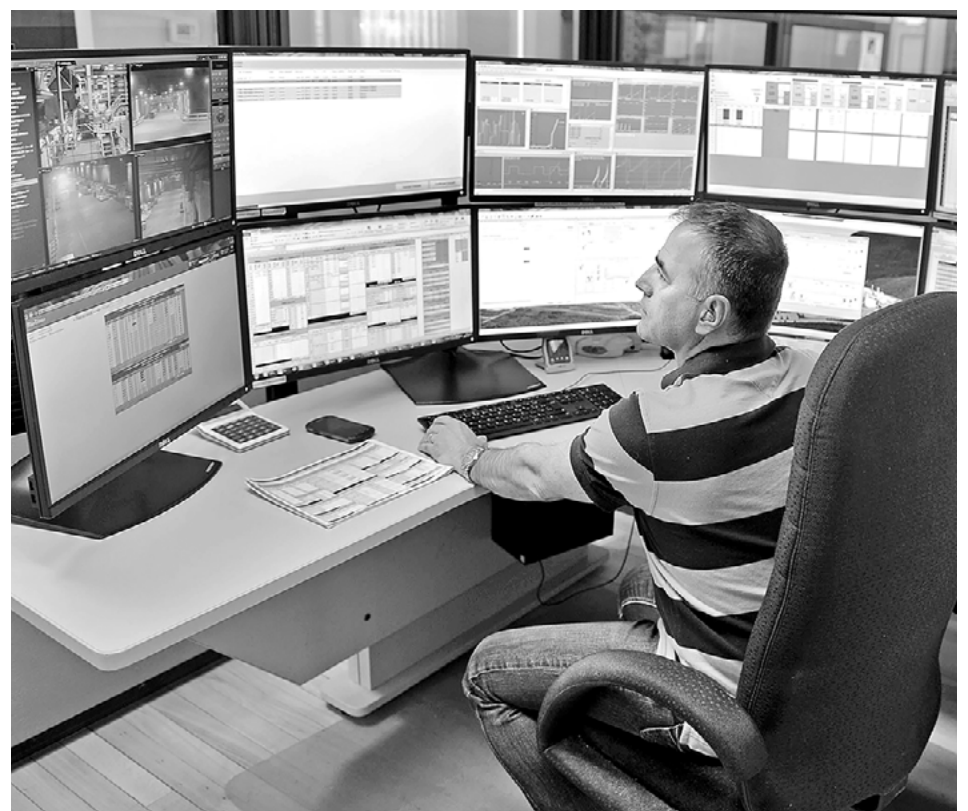
SUR LA PHOTO : Germain Perron travaille au nouveau poste de travail permettant aux répartiteurs de suivre les opérations de nos installations, incluant celle de Kitimat.
