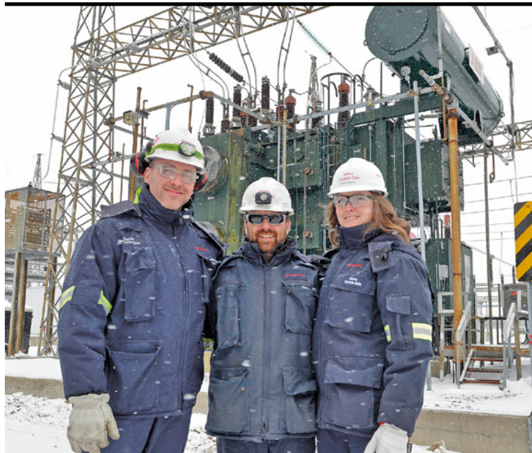
Patrick Lalancette, ingénieur électrique à la haute tension, Jimmy Bilodeau, électrotechnicien à la haute tension et Sonia Simard, chef de projet.
