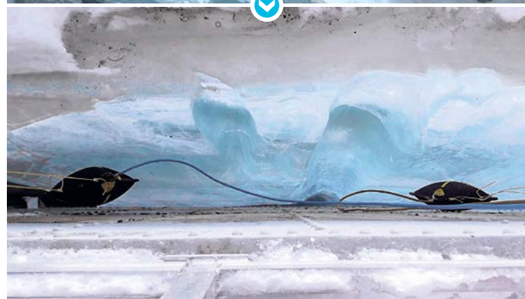
Les ballons gonflables sont insérés à des endroits stratégiques afin de faire tomber les murs de glace. Sécuritaire et efficace, l'innovation permet aussi d'éviter d'éventuels bris sur les vannes des déversoirs.
