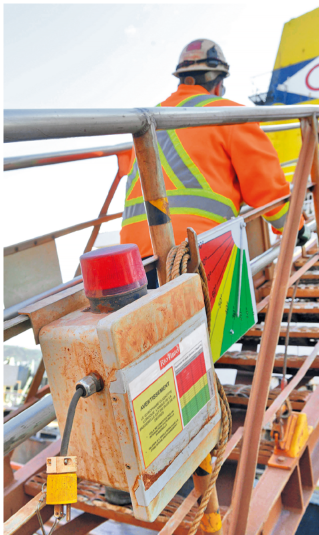
Les indicateurs de niveau ont été installés sur chacune des passerelles d'accès aux navires. Ils ont été conçus par Mathieu St-Gelais, Keven Goyette, Hugues Blais, Pascal Murray, Daniel Potvin, Jean-Daniel Lavoie et Maxime Tessier.
